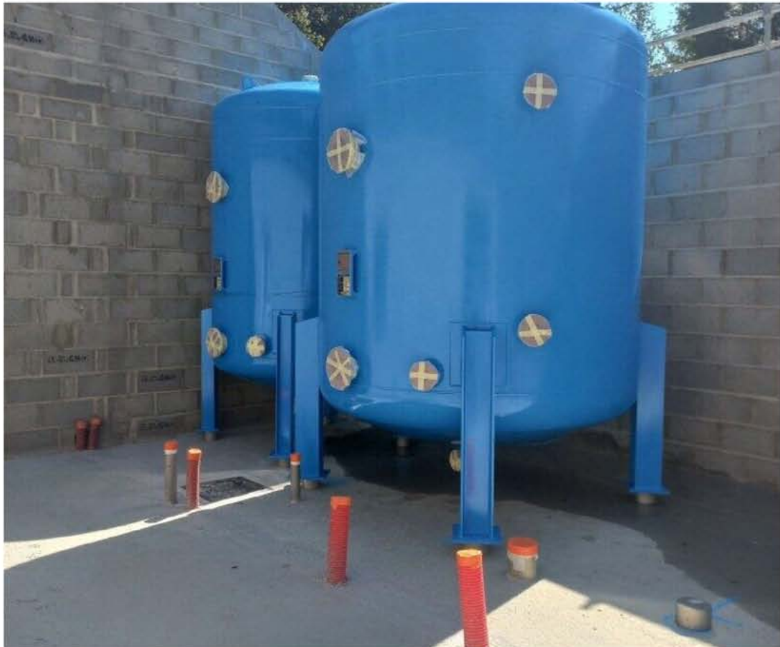
Les filtres à sable et à charbon actif permettront de retirer les pesticides et le fer dans deau. ©Photo transmise par
