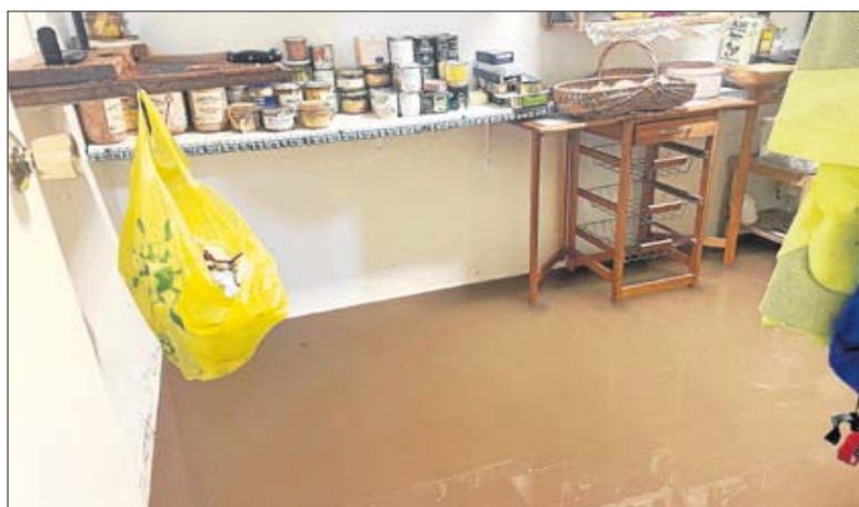
La despensa de una casa de Ciutat Jardí, completamente anegada.
